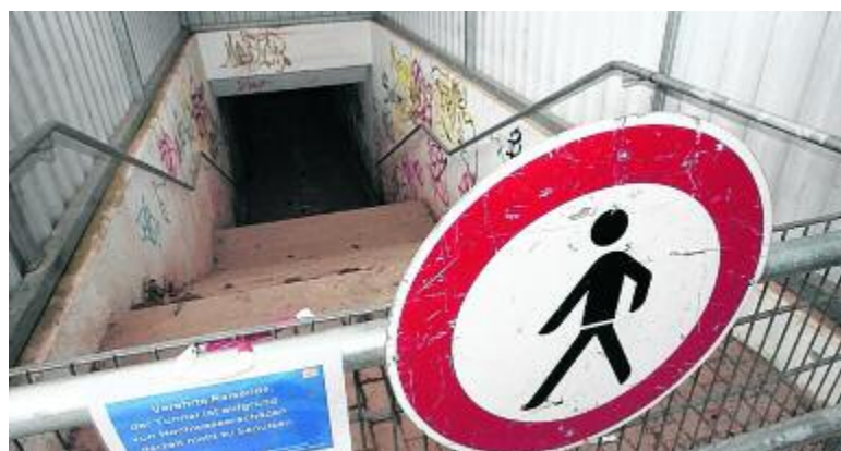
Nach Anwohnerbeschwerden wird die Deutsche Bahn den gesperrten Fußgängertunnel in Harthau nun doch wieder öffnen. FOTO: ANDREAS TRUXA
